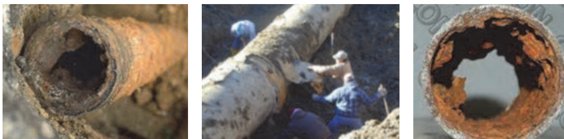
شکل ۴- نمونه‌ای از خوردگی لوله‌های دفن شده
